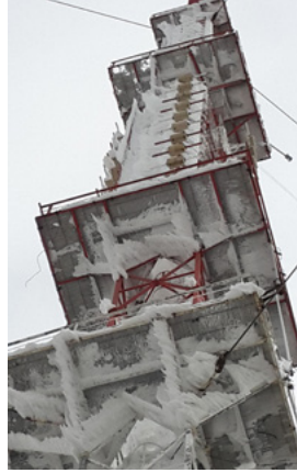
Eskişehir-Merkez Verici İstasyonu
